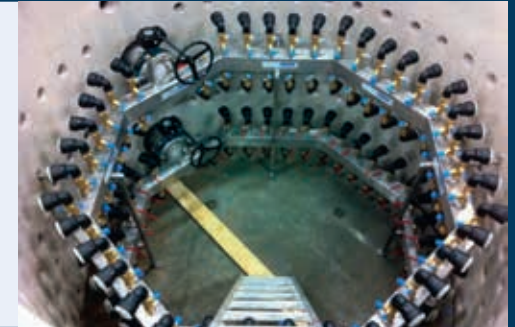
Samlebrønd til jordvarmeanlæg
